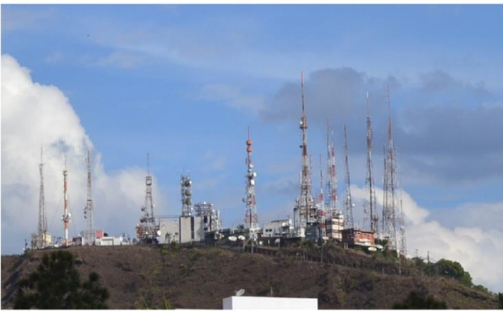
Antenas de telecomunicação
